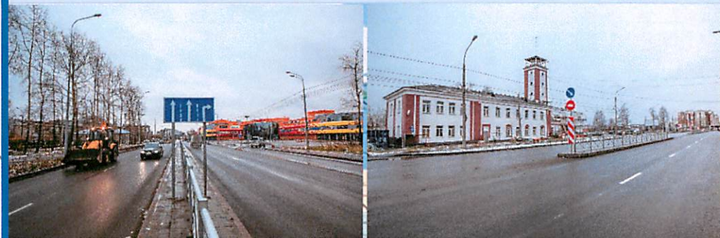
Реконструкция проспекта Ленинградского от ул. Первомайской до ул. Смольный Буян в г. Архангельске
