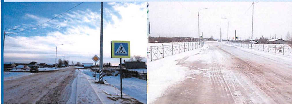
Реконструкция автомобильной дороги Усть-Ваеньга – Осиново – Фалюки (до дер. Задориха) на участке км 43 + 500 – км 63 + 000
